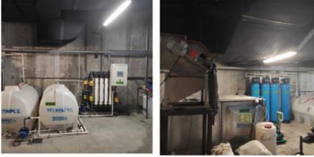
Resim 7: AGÜ Rektörlük, İdari ve Derslikler binasında bulunan gri su sistemi elemanları
